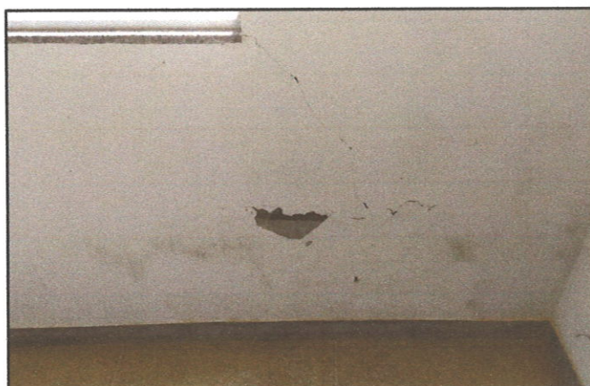
FIGURA 05 - Manchas nas paredes
